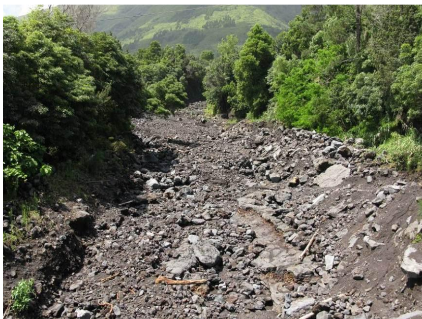
Figura 2.9.34 | Aspecto de uma estrada próxima de S. João após um período de chuva.
